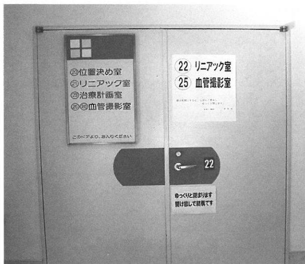
図8 治療室・血管撮影室入り口防火扉
